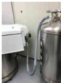
加圧容器をつないだ状態
